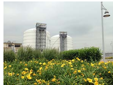
LNG storage tanks at Everett LNG facility
